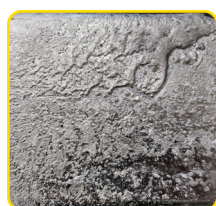
Förtjockning av beläggningen
